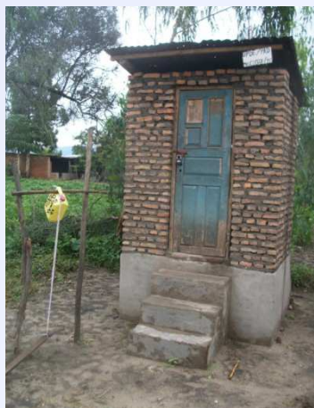
Latrine domiciliaire ecosan à déshydratation, et système de lavage des mains
